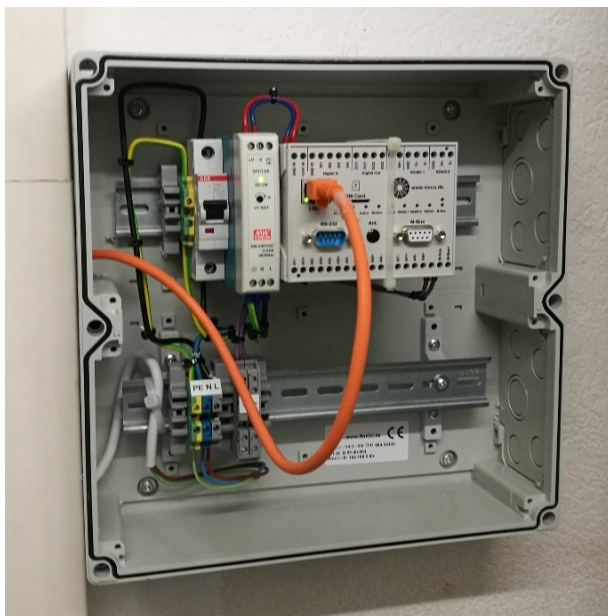
Quelle: energo, 2017 - Datenlogger im Einsatz
